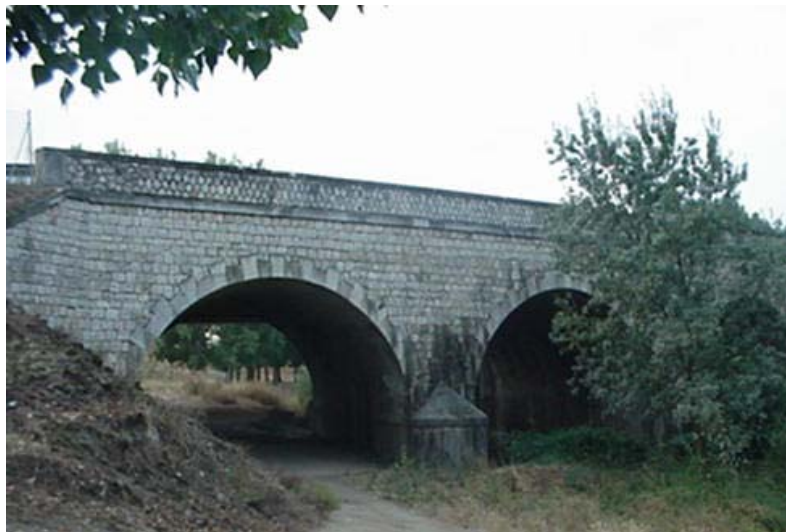
Foto 11: Juntas ortogonales al intradós en el Puente sobre el arroyo de Confort
