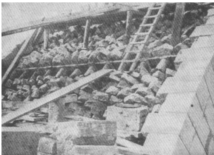
Foto 13: Irregularidades del trasdós de una bóveda (fotografía tomada de RIBERA)
