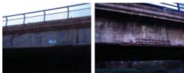
Figuras 4 y 5.- Ejemplos de deterioro.
