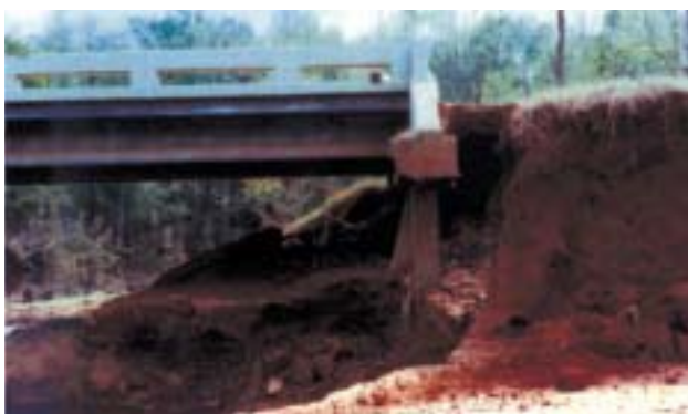
Figura 15.- Erosión de la margen.
