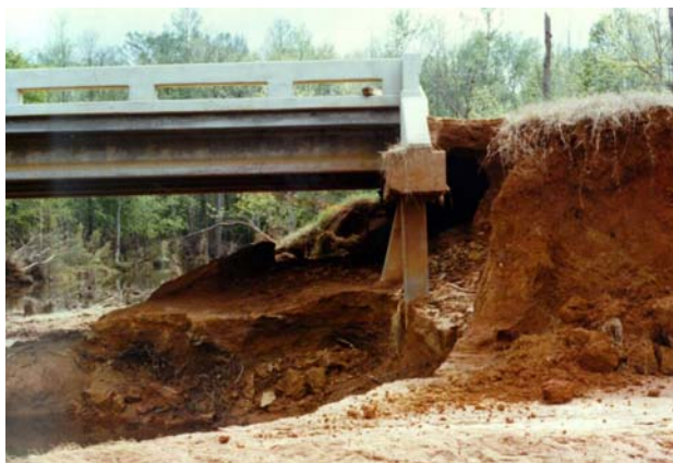
Figura 10. Erosión de la margen
