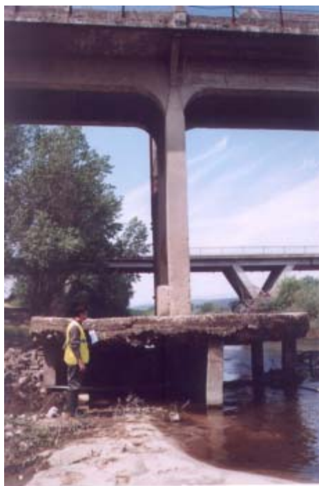
Figura 5. Socavación con cimentación profunda
