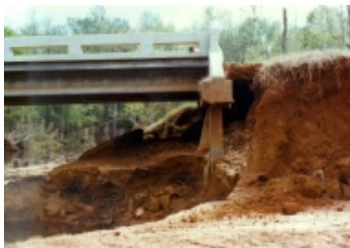
Figura 10. Erosión de la margen
