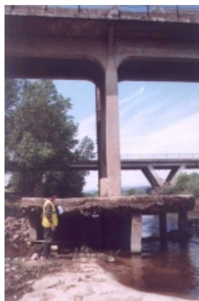
Figura 5. Socavación con cimentación profunda
