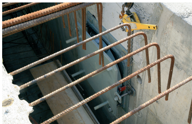
Figura 26. Apoyo POT instrumentado en estribo E1
