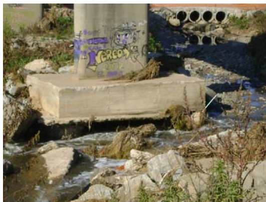
Figura 3 – Descalce en pila
