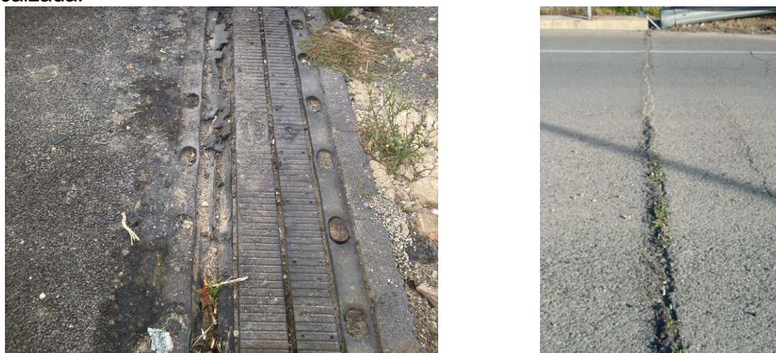
Figura 6 - Junta de calzada deteriorada o inexistencia de junta de calzada
