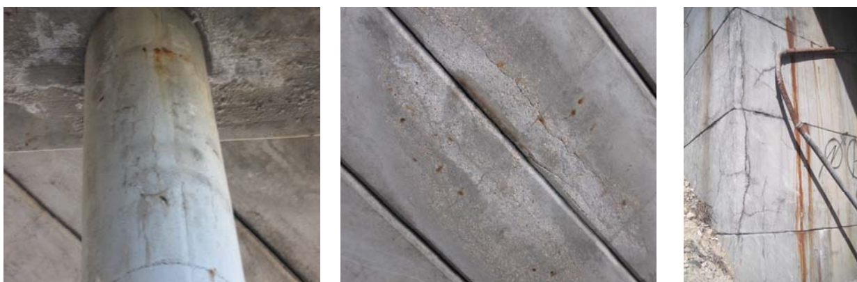
Figura 2 - Fisuras en fuste de pila, en vigas de tablero y en muro frontal de estribo
