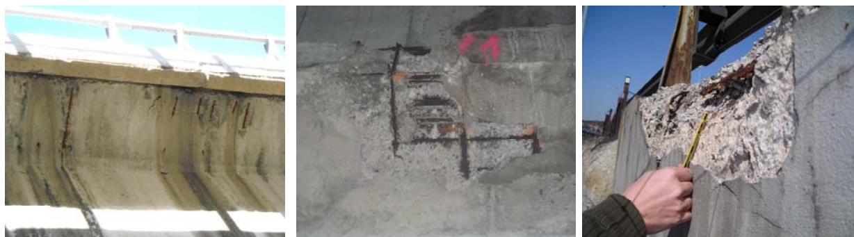
Figura 4 - Armaduras a la vista con rastros de oxidación y desconchón en paramento de hormigón
