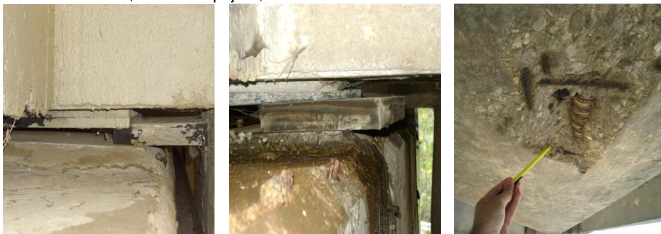
Figura 11 -Apoyos desplazados de su posición teórica y vaina de pretensado expuesta
