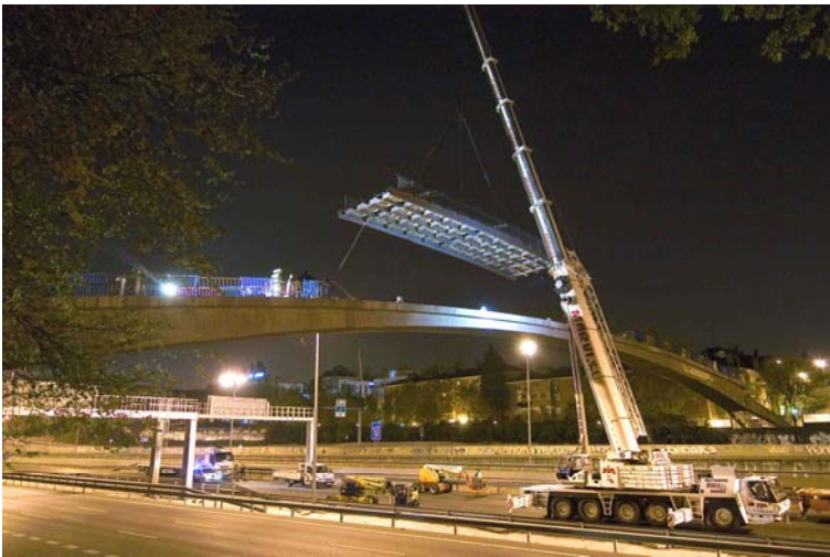
Figura 7. Montaje con grúa del primer tramo de tablero sobre el arco, la noche del 2 de abril de 2009.
