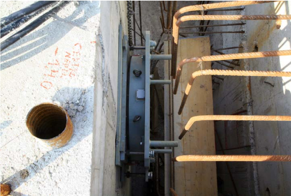
Figura 4. Apoyo POT instrumentado en estribo sur.
