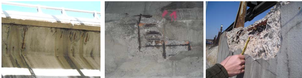
Figura 6. Armaduras a la vista con rastros de oxidación y desconchón en paramento de hormigón
