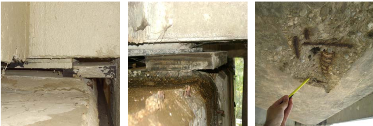
Figura 8. Apoyos desplazados y vaina de pretensado expuesta
