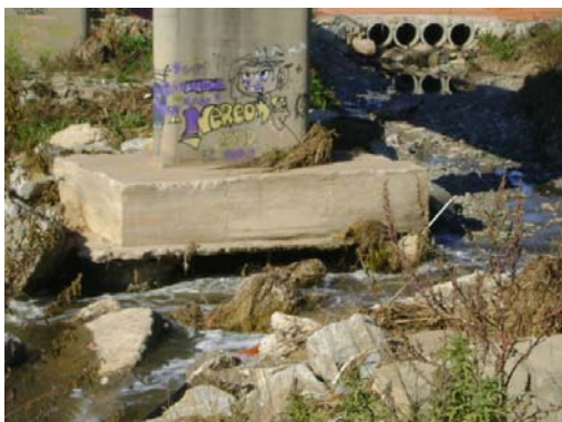
Figura 3. Descalce en cimentación por socavación
