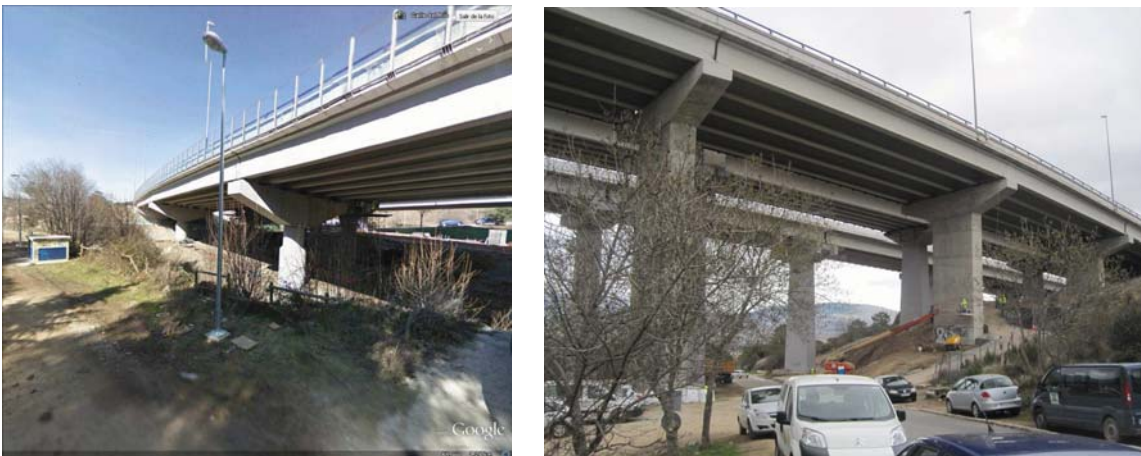
Figura 1. Viaductos de San Rafael y de La Jarosa (Actual calzada sentido Madrid)
