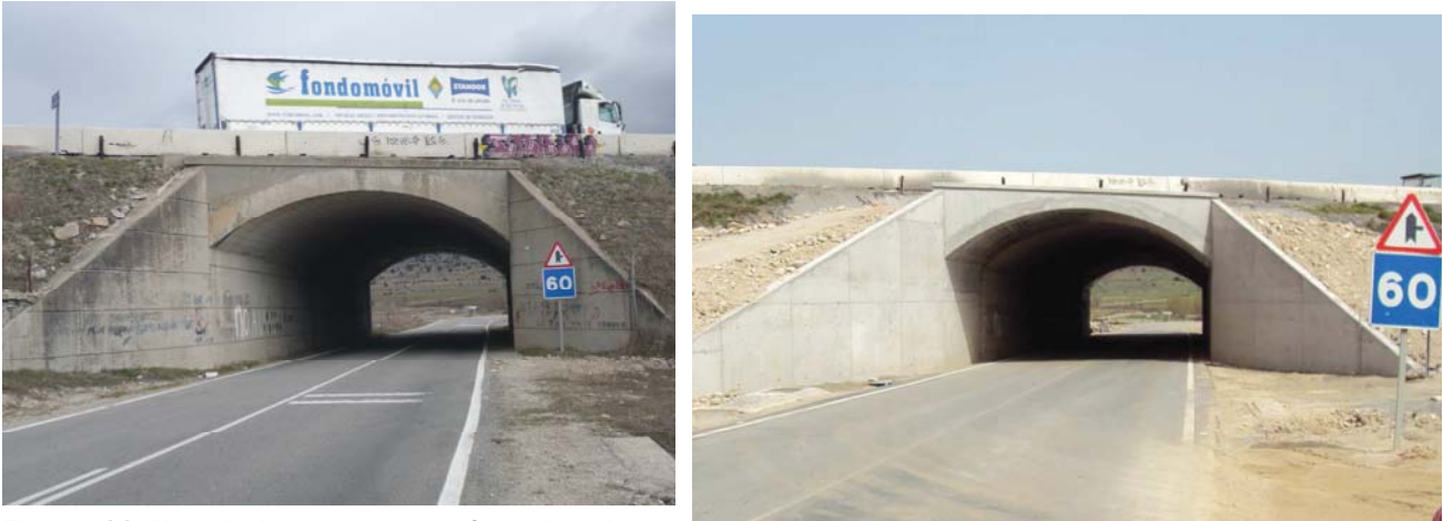
Figura 11. Uno de los pontones afectados. Instantáneas antes y después de la ampliación
